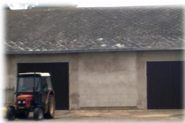
Rysunek 1. Wyroby azbestowo-cementowe: po lewej na górze płyty faliste, po prawej na dole płyty płaskie (źródło: materiały własne).
